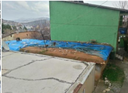
Çatıda, ahşap çatı örtüsü ve hiçbir yalıtım uygulaması yapılmadığı için betonda çatlamalar oluşmuştur.
