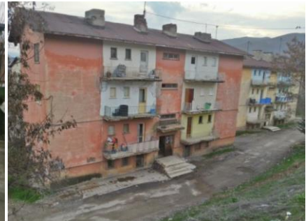
Uzun süreli su, nem ve don kaynaklı dış etkilere maruz kalan yapının dış cephesi, çatısı, bacaları, balkonu ve tretuvar çevresi belirgin bir şekilde hasar görmüştür.
